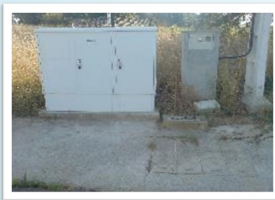
ARMARIO DE PEDESTAL E ARQUETA
