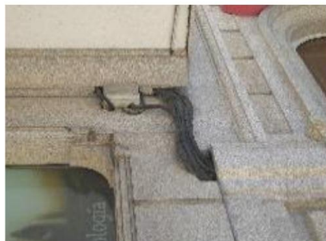
CABLEADO POR FACHADA CAMUFLADO CON MOLDURA
