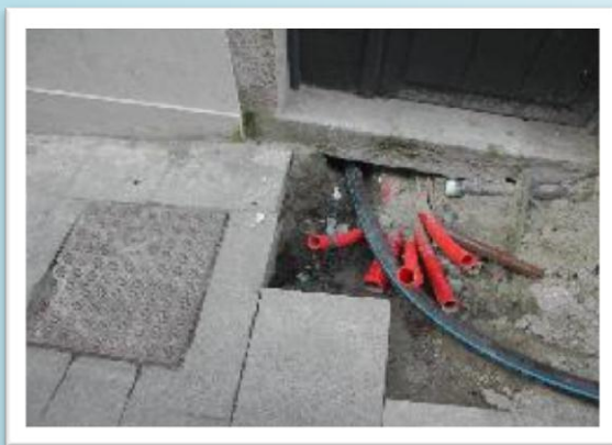
TUBOS DE ICT (saída a arqueta)
