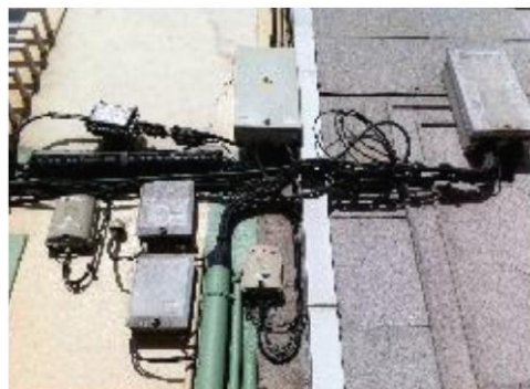
CABLEADO POR FACHADA "NORMAL"
