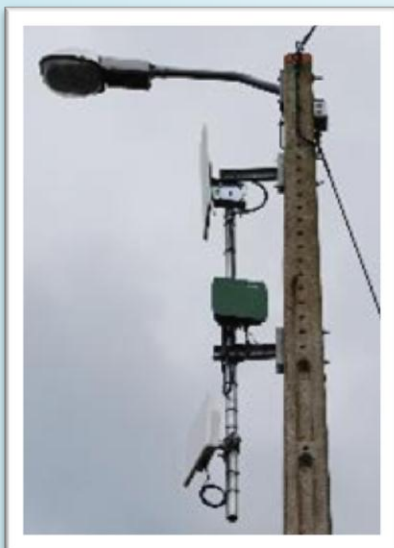
ESTACIÓN DE COBERTURA WIMAX EN POSTE ALUMEADO
